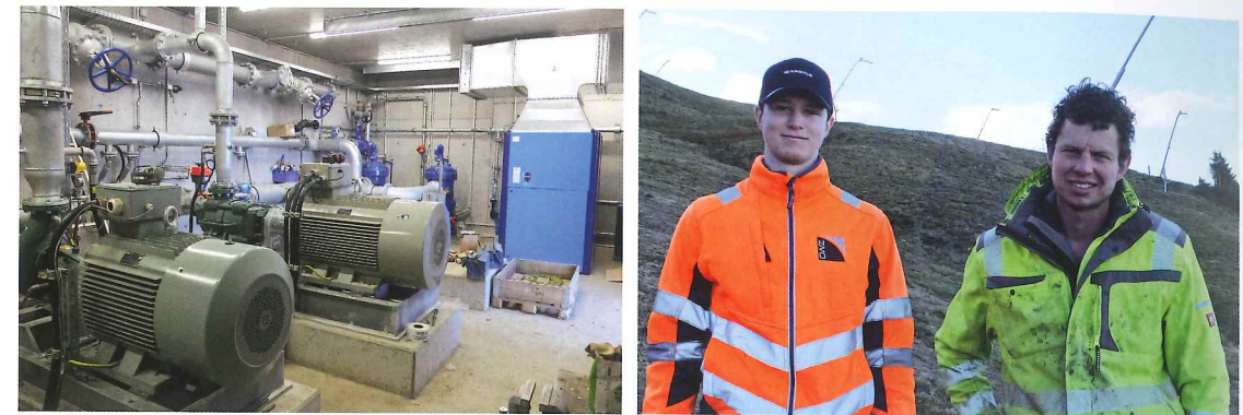
Die neue Pumpstation auf 2000 m ü. M. zeichnet sich mit einem geringen Energieaufwand aus. Alessio Wyrsh, CWZ, links und Stephan Kappelmeier, Anlagenbau, betreuen das komplexe Projekt.
