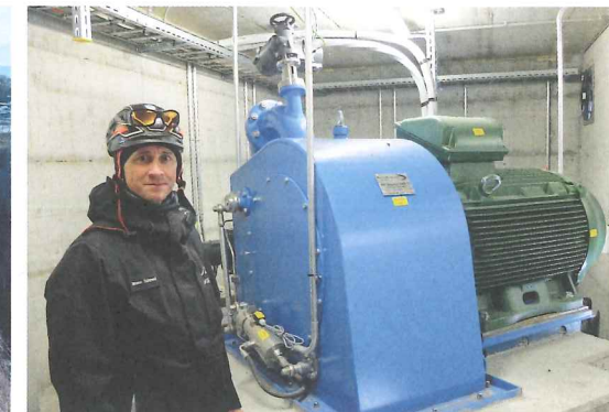
Marco Schmed, technischer Leiter, bei der neuen Turbine am Speichersee Catrina, die zur Energiegewinnung genutzt wird.
