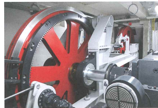
Die komplette Seilbahntechnik stammt von Steurer Seilbahnen AG. Der Einbau der Antriebstechnik war eine herausfordernde Aufgabe in der engen Bergstation.
